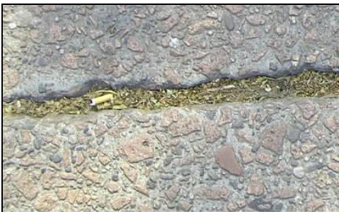
Figura 4: Degrado dei giunti non sigillati
