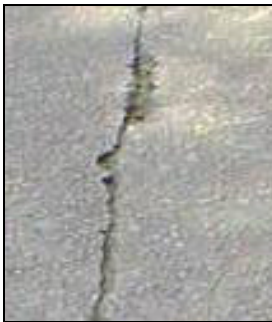
Figura 2: Esempio di fessurazione longitudinale
