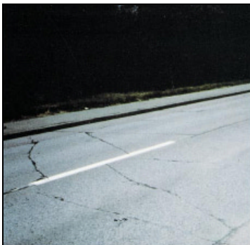
Figura 3: Esempio di fessurazione trasversale
