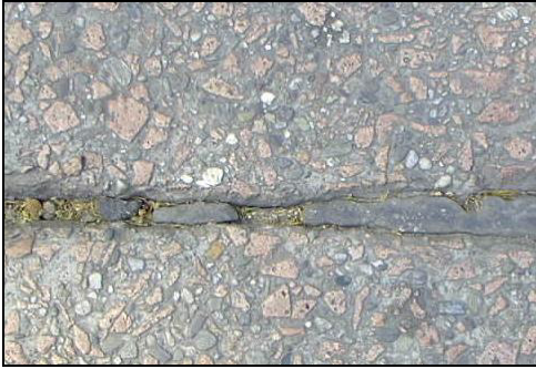
Figura 5: Degrado dei giunti precedentemente sigillati
