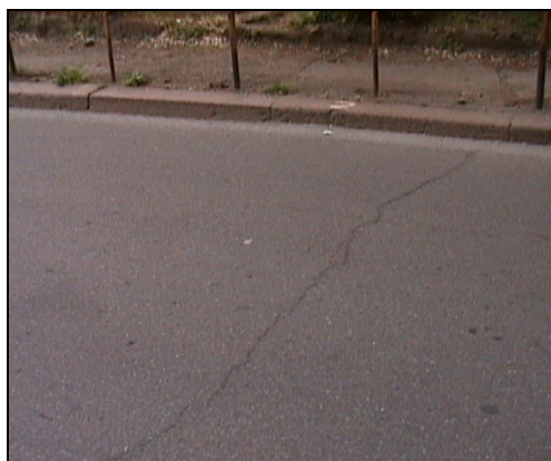
Figura 10: Esempio di fessura trasversale
