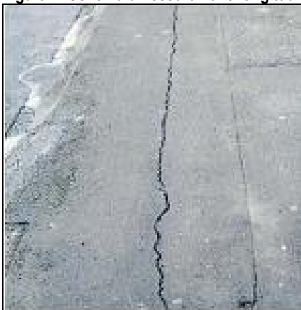
Figura 8: Esempio di fessura longitudinale
