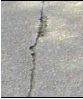
Figura 2: Esempio di fessurazione longitudinale
