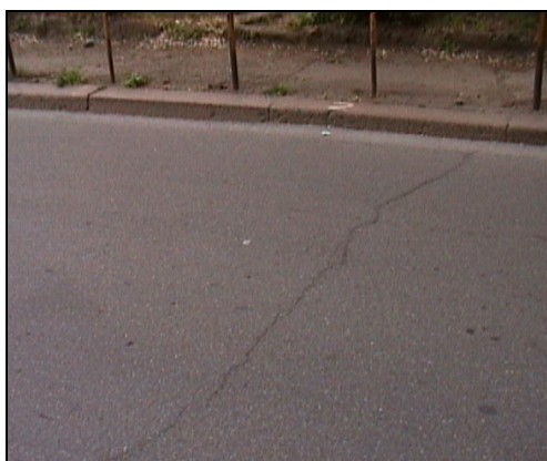
Figura 10: Esempio di fessura trasversale
