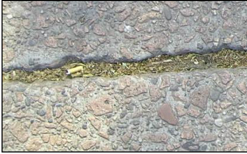
Figura 4: Degradamento dei giunti non sigillati
