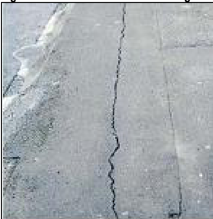
Figura 8: Esempio di fessura longitudinale
