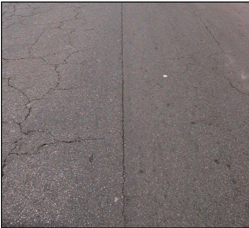
Figura 11: Fessura longitudinale da giunto di stesa.
