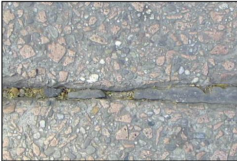
Figura 5: Degradamento dei giunti precedentemente sigillati
