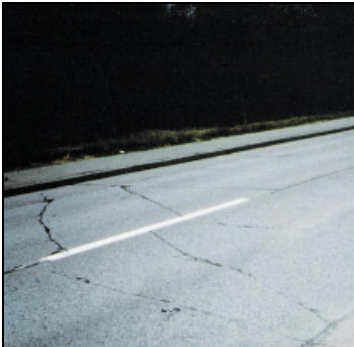
Figura 3: Esempio di fessurazione trasversale
